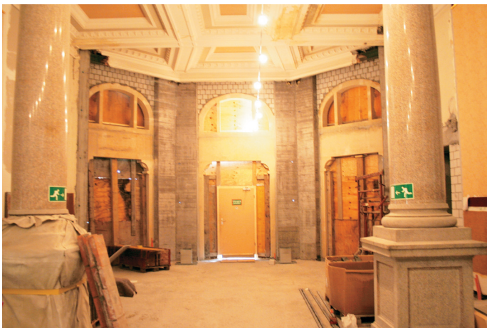
Vom Haupteingang aus gelangt man in die Steinhalle, welche originalgetreu saniert und wiederhergestellt wird. (Bilder: re)
